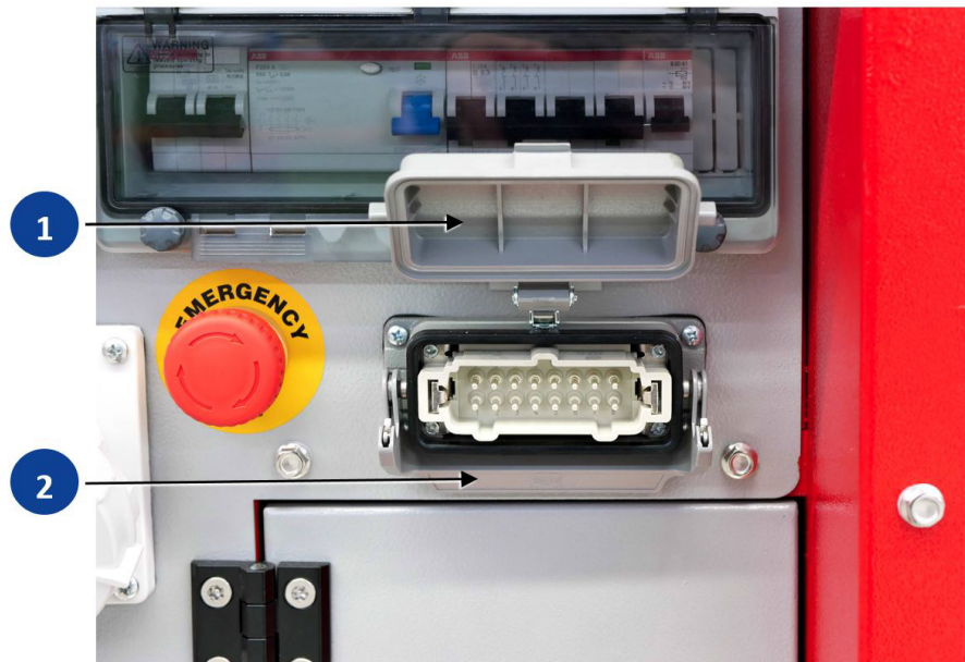
Kuva 8-6 Etäkäynnistyslaite ja HARTING®-pistorasia
